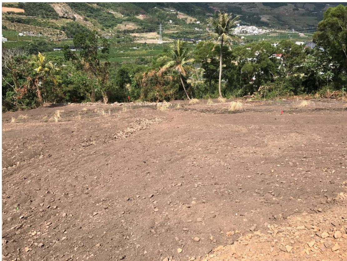
▲紅色標竿下方區域為越界開挖鐵路局之土地部分
